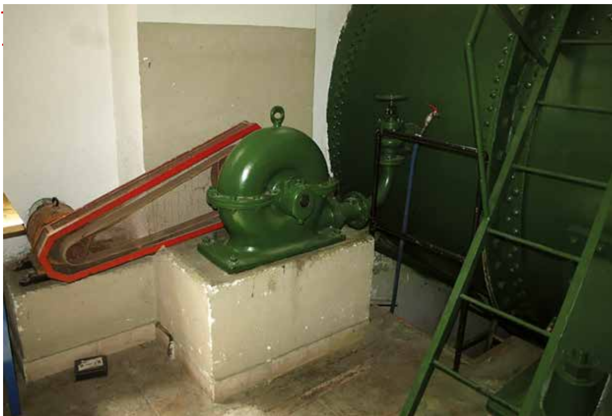
Ulaz tlačnog cjevovoda u strojarnicu HE Jaruga — priključena je mala Pelton turbina koja nije u pogonu
