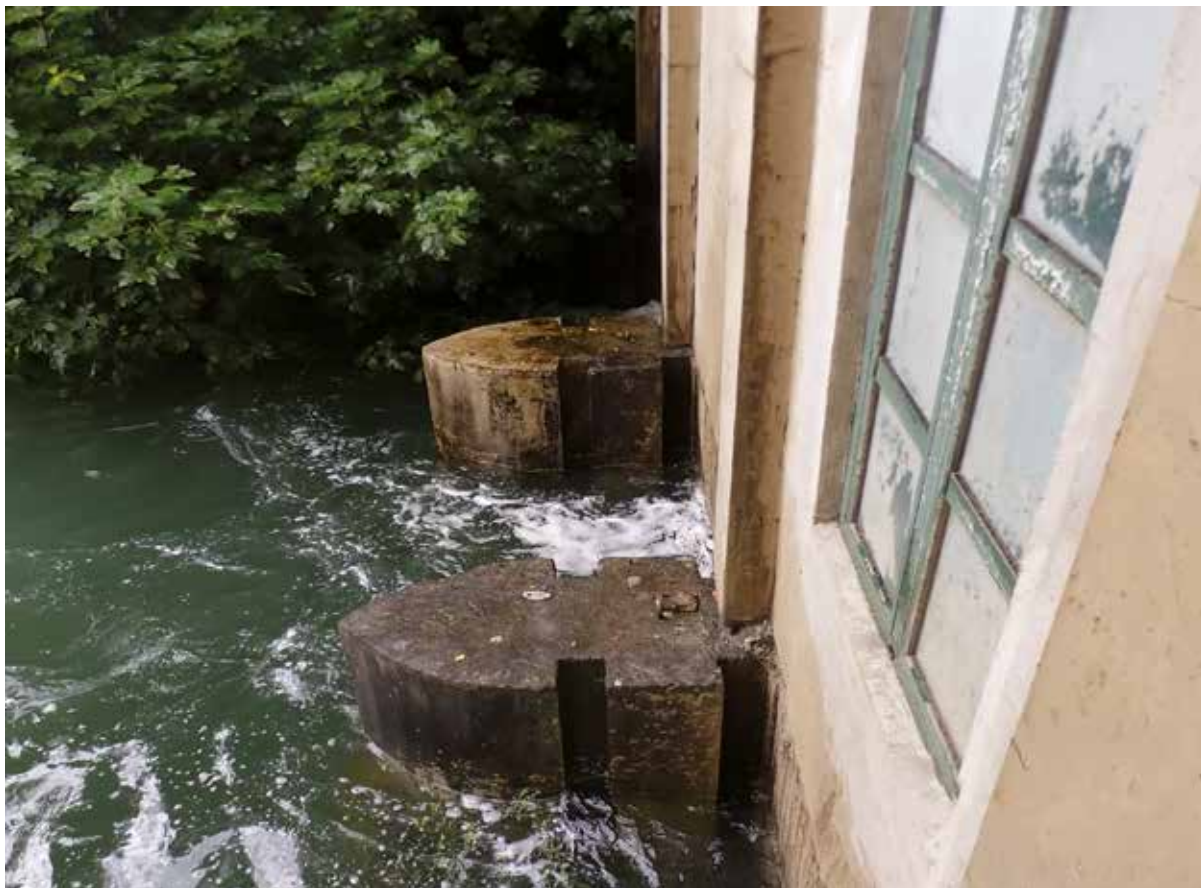
Ulazna građevina s tablastim zatvaračima s cilindrima za pokretanje zatvarača
