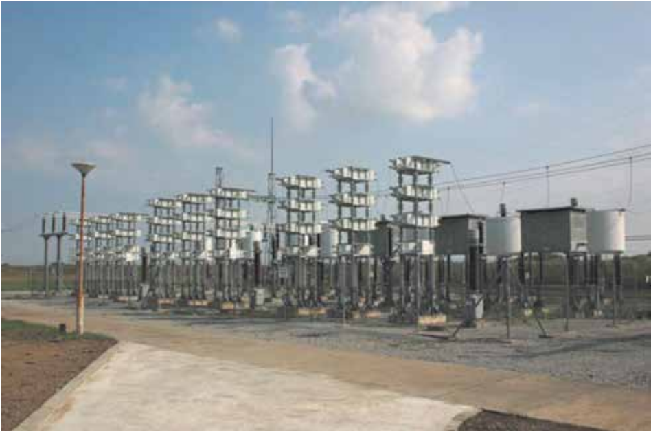
Slika 2.: Postrojenje sustavne kompenzacije od 110 kV, 48 Mvar, u TS 220/110 kV Đakovo
